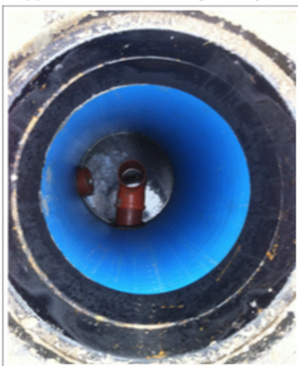
Flytslam spärren med invändigt t-rör.
