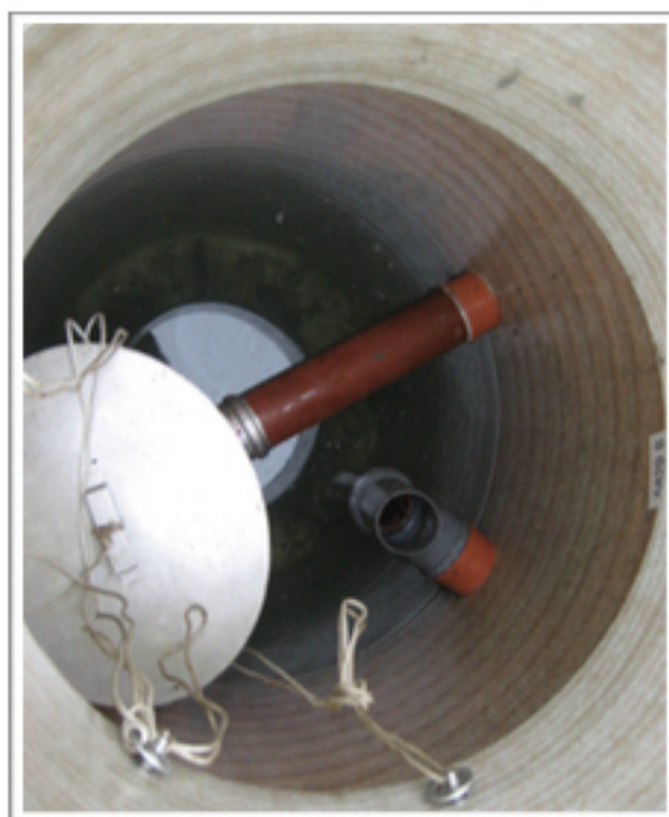
Installation med slamfång och olje-avskiljning utanför filter insatsen.
